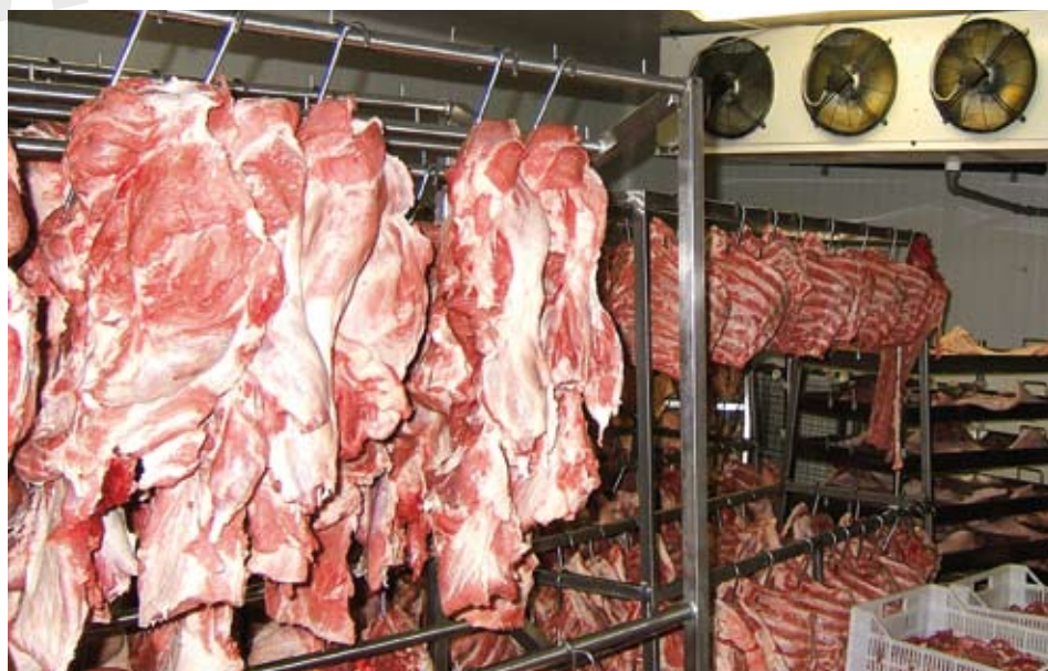
Tunnel di congelamento
