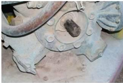
Fig. 6 - presa di forza senza protezione
